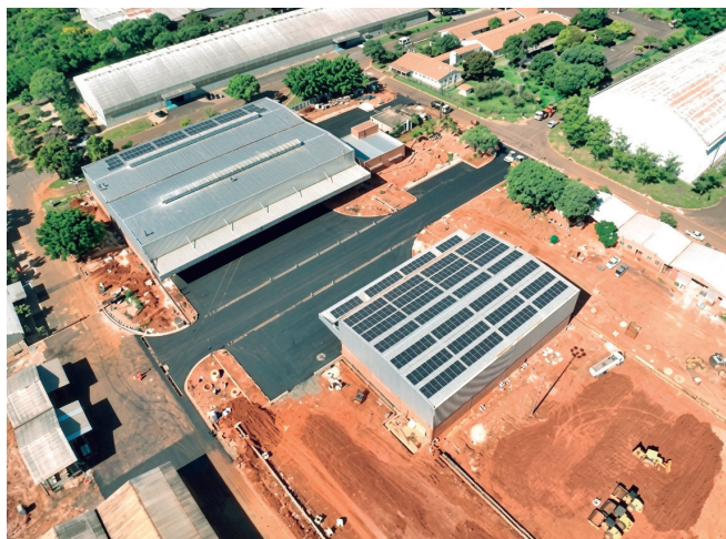
Vista aérea de la construcción de los almacenes de la margen brasileña
