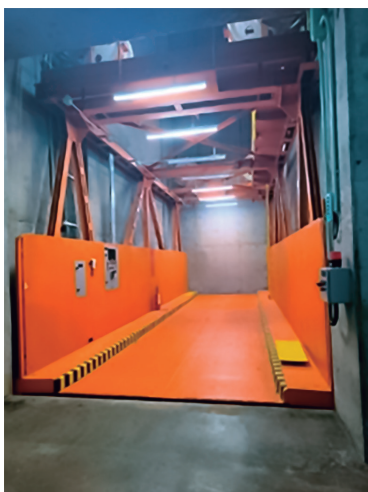
Montacargas localizado en el AMD
