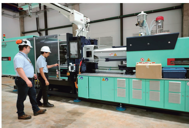
Maquinarias para el funcionamiento del Centro TASK
