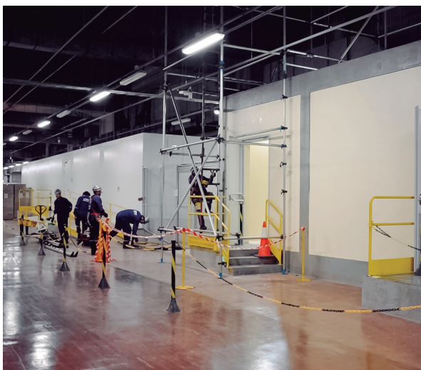
Sala segura, Sala cofre y Sala eléctrica
