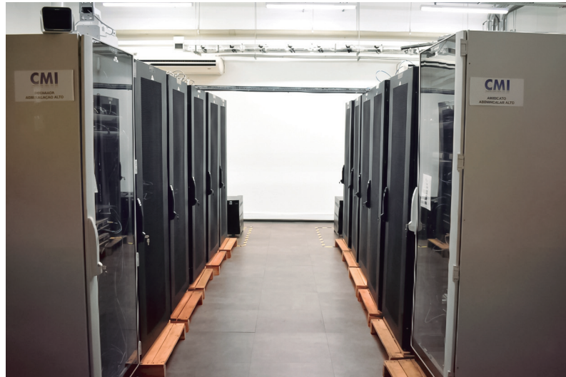
Equipos de la RTA instalados en el CINTESC
