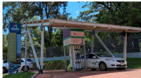
Estación de recarga en operación
