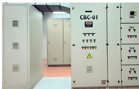
Nuevos paneles CBC-01 y CBC-02
