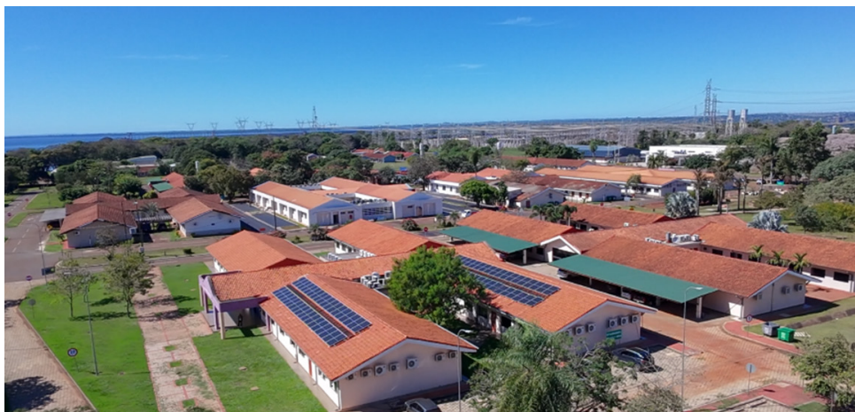
Sistema de generación solar sobre techado
