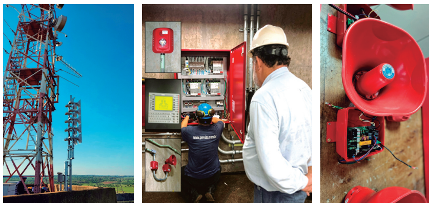
Sistema de alerta sonora de emergencia
