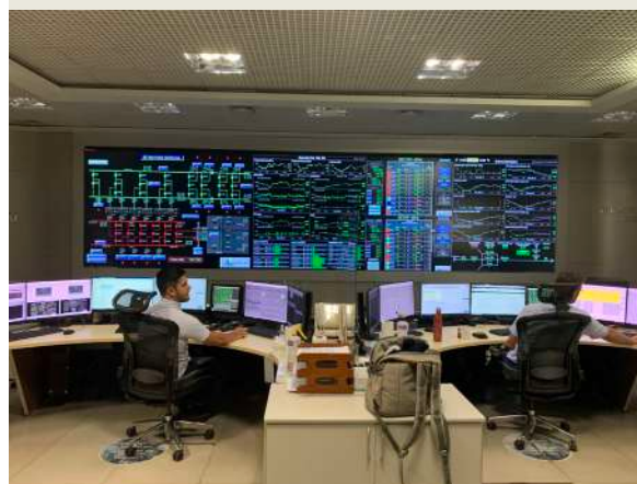
1.3.2 Consoles de operação e video wall no Despacho de Carga.
