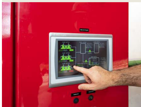
1.3.13 Nosso sistema anti-incêndio da SEMD.
