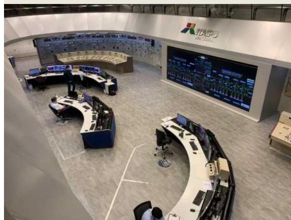
1.3.2 Consoles de operação e video wall na CCR.
