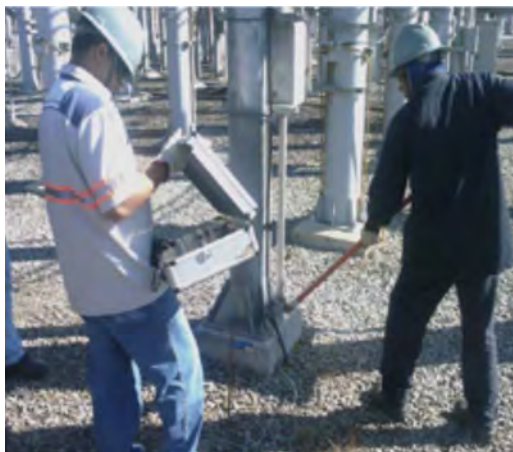
Medición de Sistema de Puesta a Tierra Sector de 500 kV.
