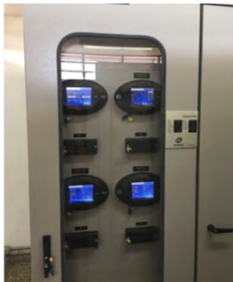
Vista del Panel Medición de Medición de Facturación.
