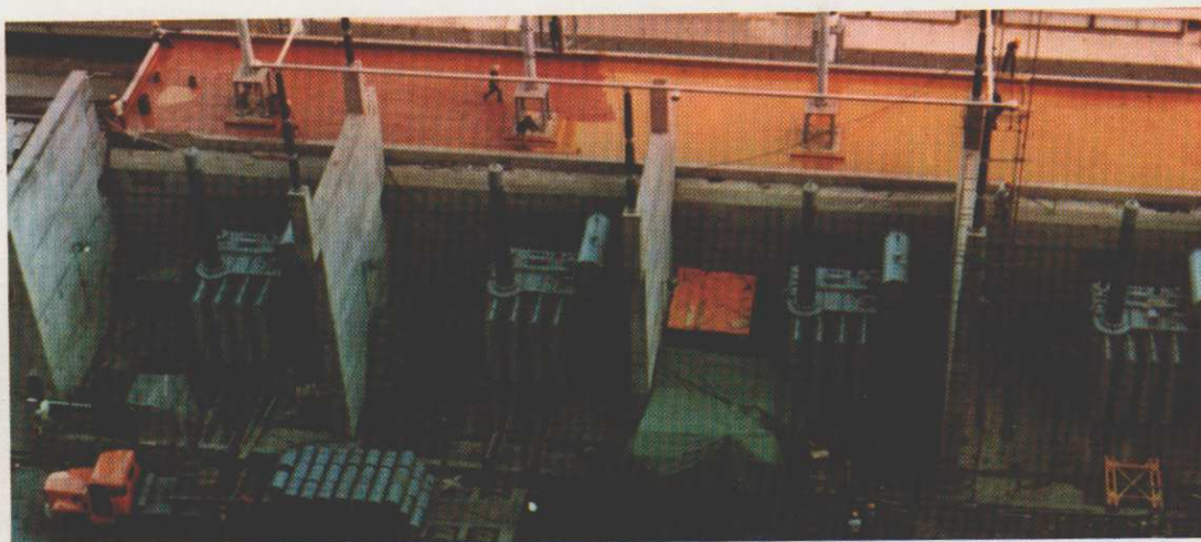
Banco n.º 1 (50 Hz) dos transformadores principais dos serviços auxiliares da casa de força, em final de montagem.
