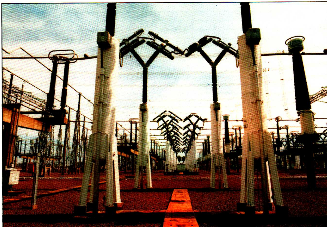
Subestação de Furnas
